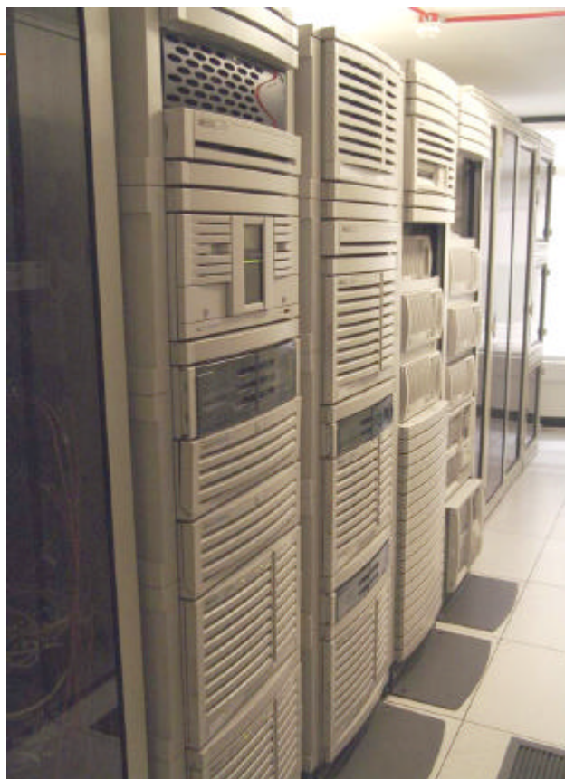
Servidores del área de Sistemas en el NOC.
